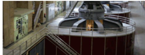
CPS® POWER SYSTEMS Energie- und Anlagentechnik
